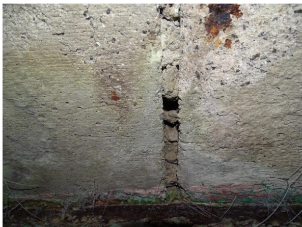
Abbildung 27: oberflächliche Risse an Stahlbeton
