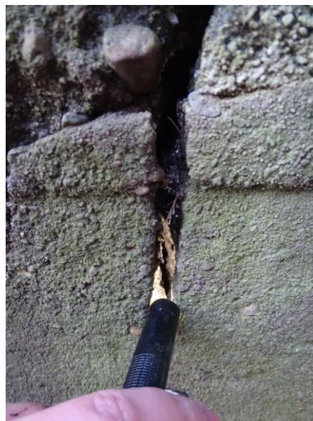
Abbildung 28: Risse am Widerlager
